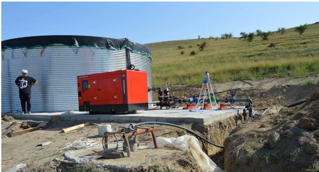
Aspect al sistemului de captare si filtrare a apei pentru irigatii (inclusiv generator electric)
