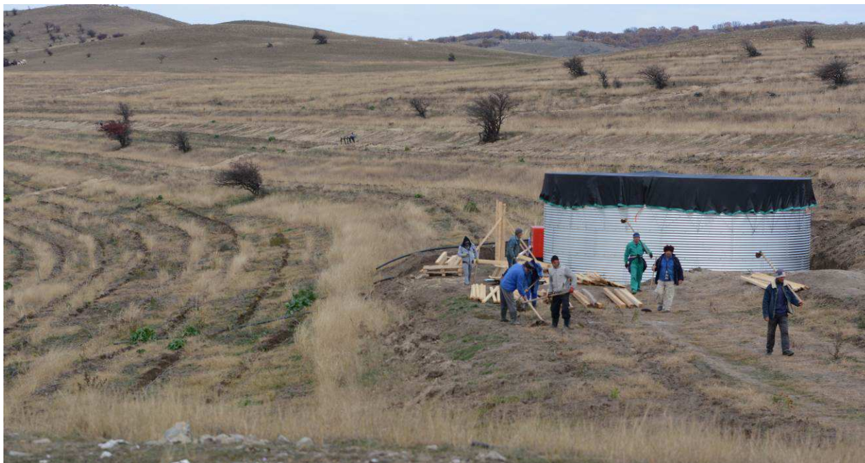
Aspect al bazinului de inmagazinare apa
