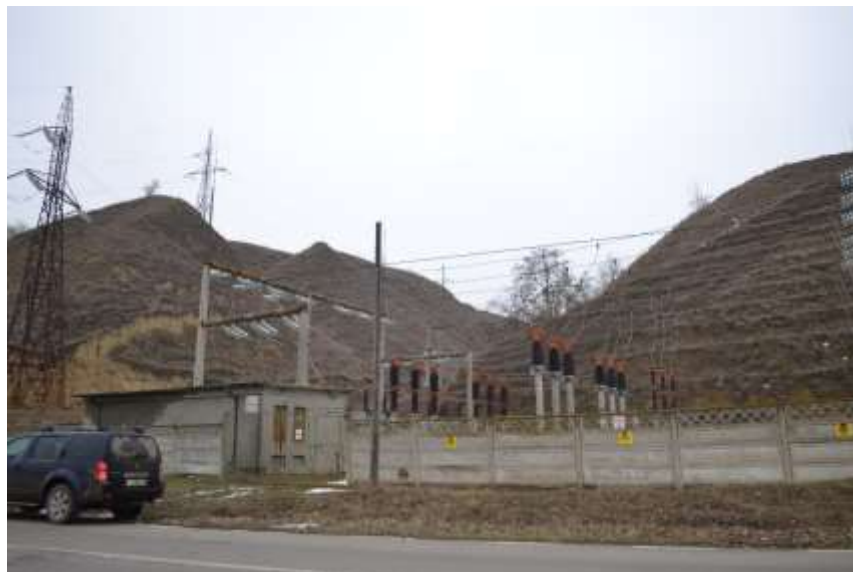
Fig.25 – stație de transformare ENEL ( trup 13 ) amplasată în ROSPA0040 Dunarea Veche- Bratul Macin și ROSCI0012 Brat Macin
