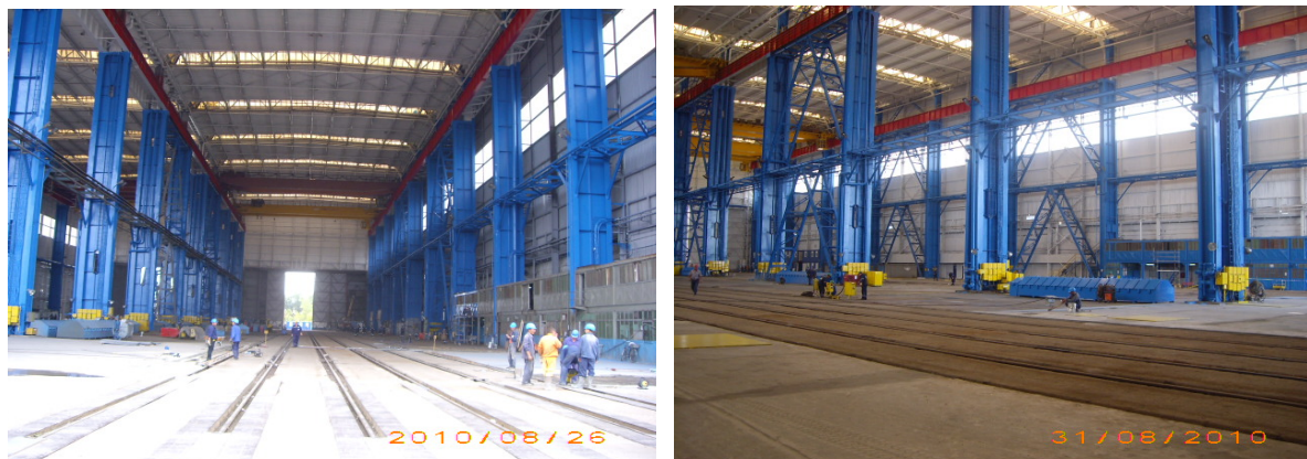
Figura nr. 15. Hala Montaj nave – Cosmetizare/Reconditionare
