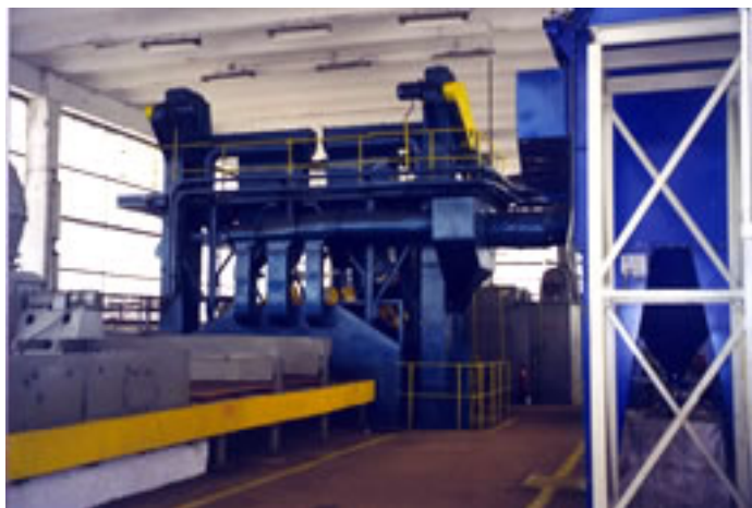
Figura nr. 22. Linia de sablare – vopsire (pasivizare) – Sectia Debitare & Fasonare
