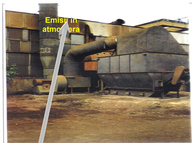
Depunere suspensii pe sol foto 9 Instalatie de curatenie aerului - desprăfuitor hidraulic de la instalatia de sablare cu alice
