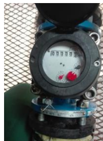
Contor montat pe traseul de evacuare digestat lichid
