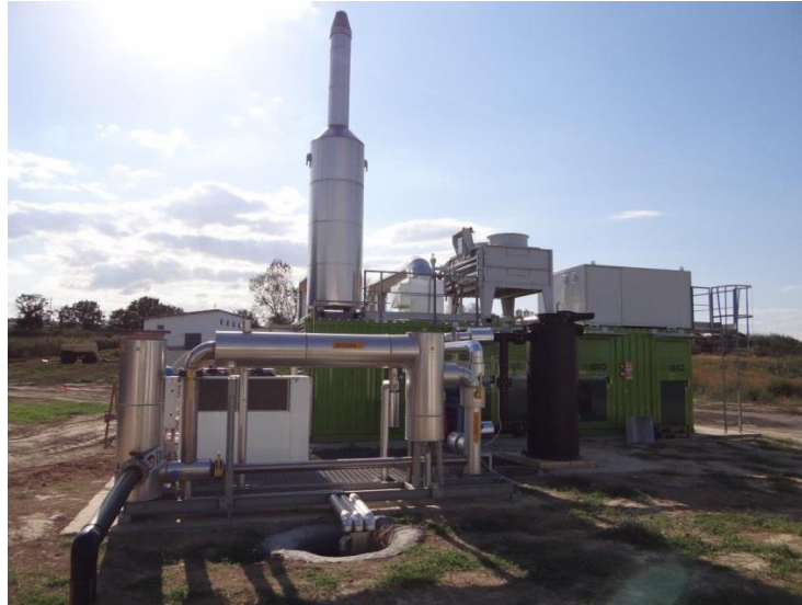
Fig. 7 – imagine instalatie de biogaz BIOCARNIC ESCO SRL
