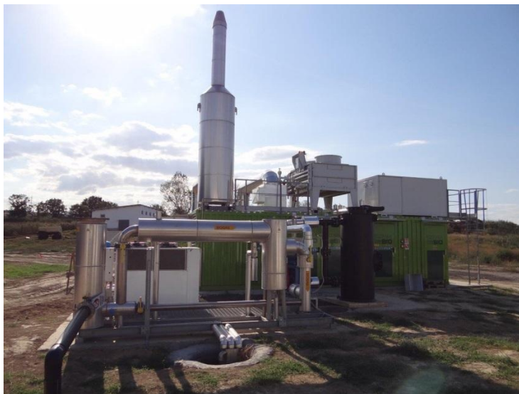
Fig. 7 – imagine instalatie de biogaz BIOCARNIC ESCO SRL
