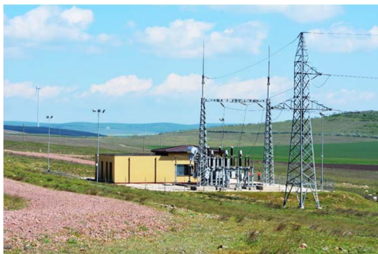
Statia de transformare
