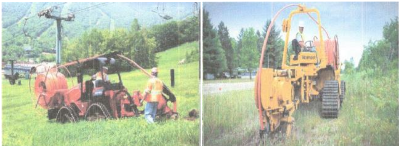
Fig. 2-3 – Utilaj specializat de ingropat fibra optica prin tub de protectie (in timpul montajului)
