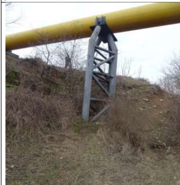
Figura nr. 34 Supratraversare existentă în punctul de intervenție TA7 – piloni de susținere
