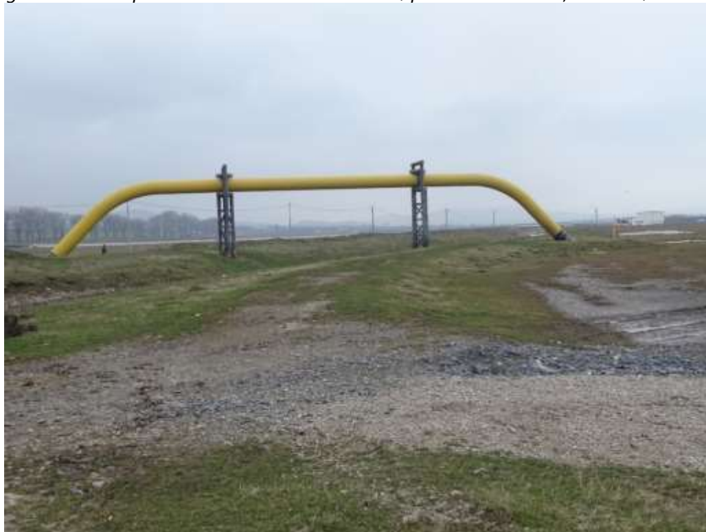
Figura nr. 2 Amplasament conducta existentă punct de intervenție supratraversarea TA 1, Mihai Bravu
