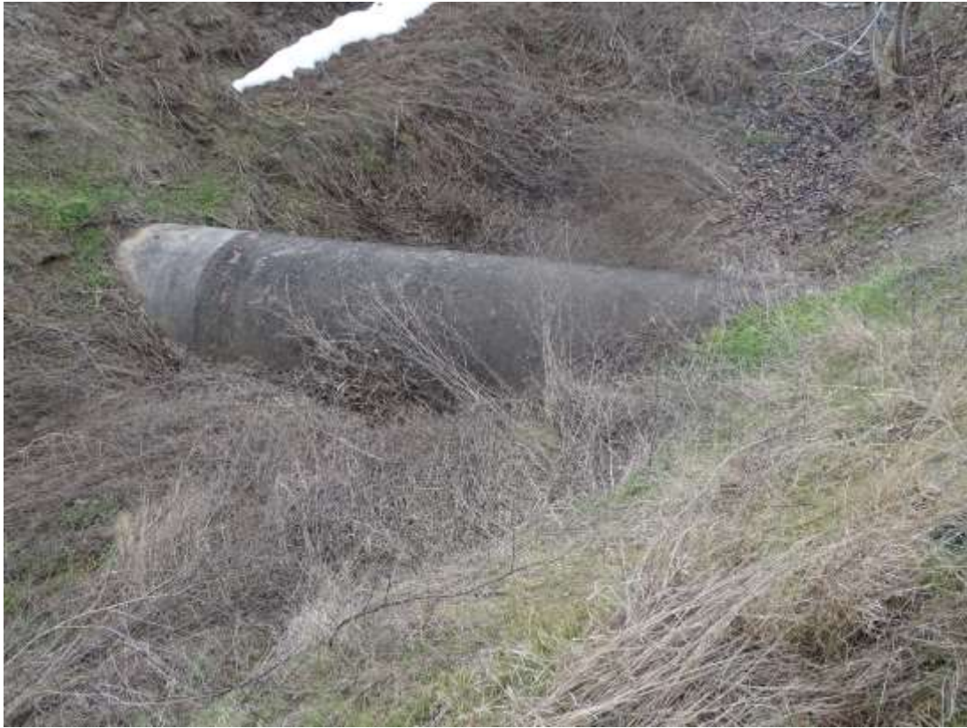
Figura nr. 15 Amplasament conducta existentă punct de intervenție reparația conductei REP 3.1, Târgușor
