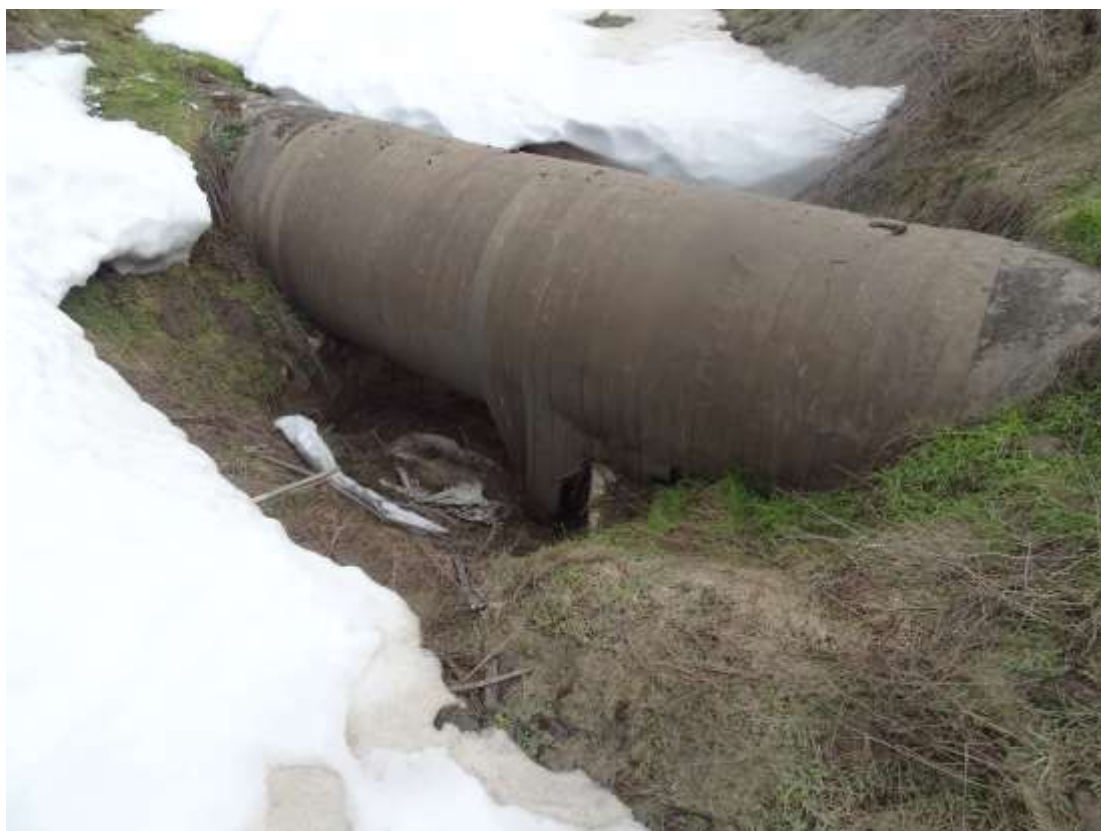
Figura nr. 14 Amplasament conducta existentă punct de intervenție reparația conductei REP 3, Târgușor
