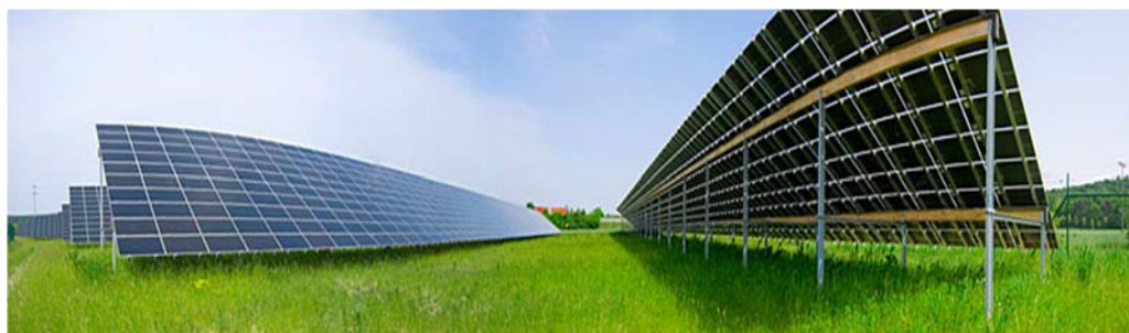
Fig. 2 – aspect panou fotovoltaic
